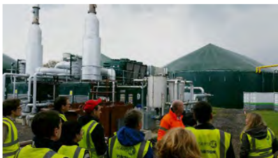
IMAGEN 11. PLANTA DE DIGESTIÓN ANAEROBIA
