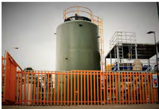
IMAGEN 10. PLANTA DE BIOGÁS UBICADA EN MILPA ALTA, CIUDAD DE MÉXICO.
